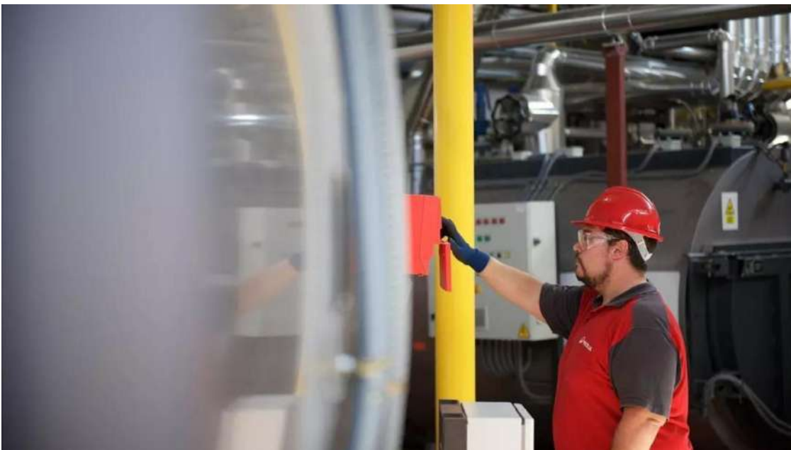
Un operario de Veolia, en una instalación del grupo Cedida
